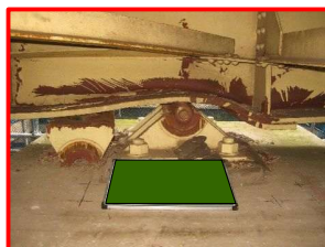
ピン支承損傷事例 (地震時)
