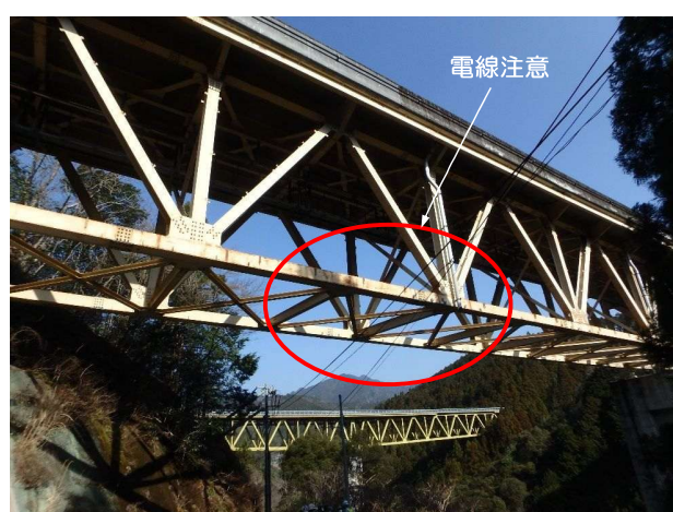
施工箇所の状況確認〔橋梁全景〕 (下弦材直下に電線あり注意)
