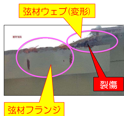
損傷部材状況
