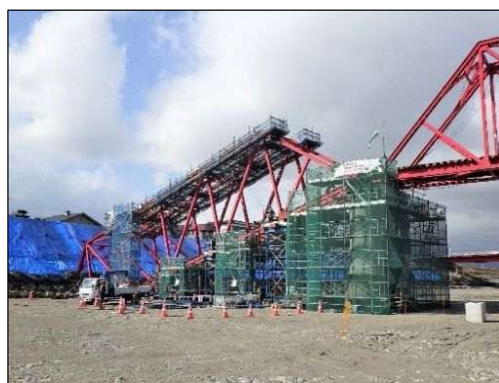
河川の増水による落橋
