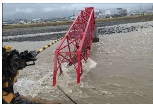
河川増水：落橋
