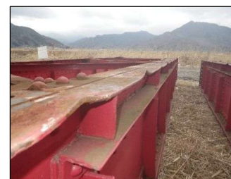
既設部材の変形状況
