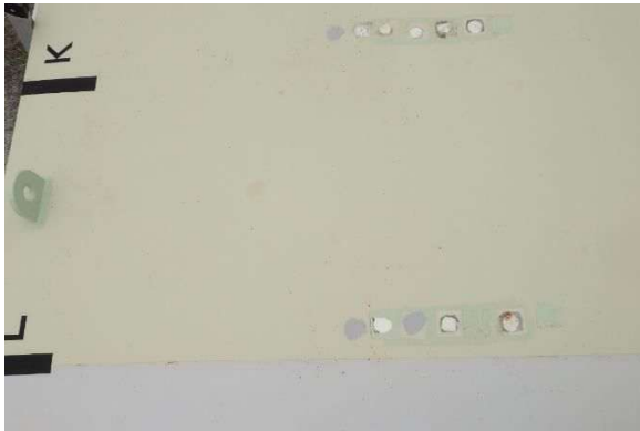
上フランジ上面: 全体的に健全
