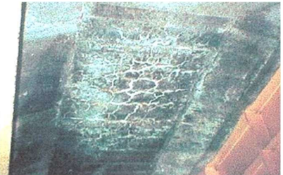
床版下面ひびわれ網細化
