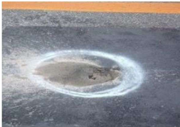
舗装損傷により浸水
