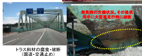
トラス斜材の腐食・破断 (国道・交通規制)
