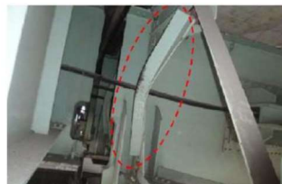
端対傾構の斜材座屈
