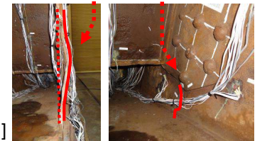
[ 実験後の 崩壊状況 ]
