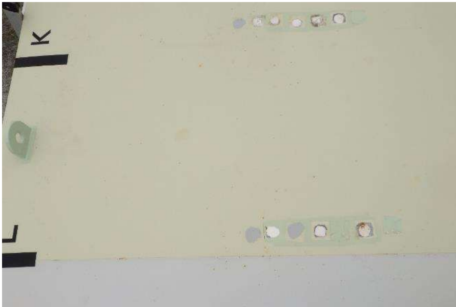
上フランジ上面: 全体的に健全
