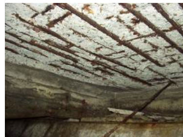
塩害により鉄筋がむき出し
