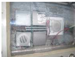
ACMセンサー類 (塔頂・橋台カバー内(上))
