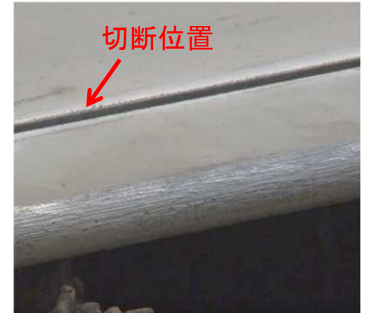
鋼板のミルエッジ
