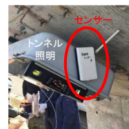
トンネル内照明の異常監視センサー
