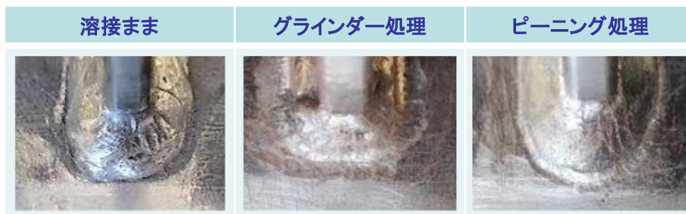
(a) 溶接止端状況
