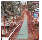
ターンバクル破断による吊橋の傾き
