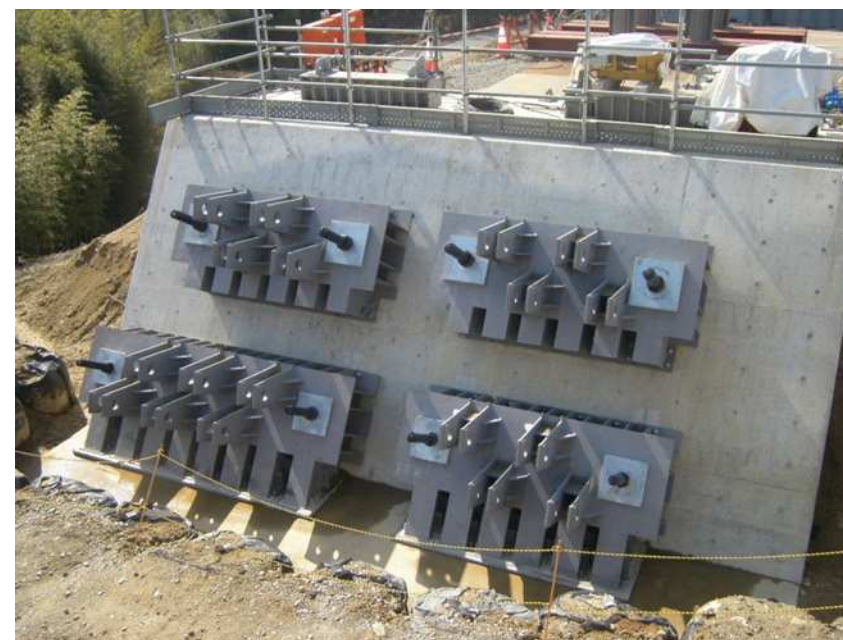
○斜吊索定着設備
