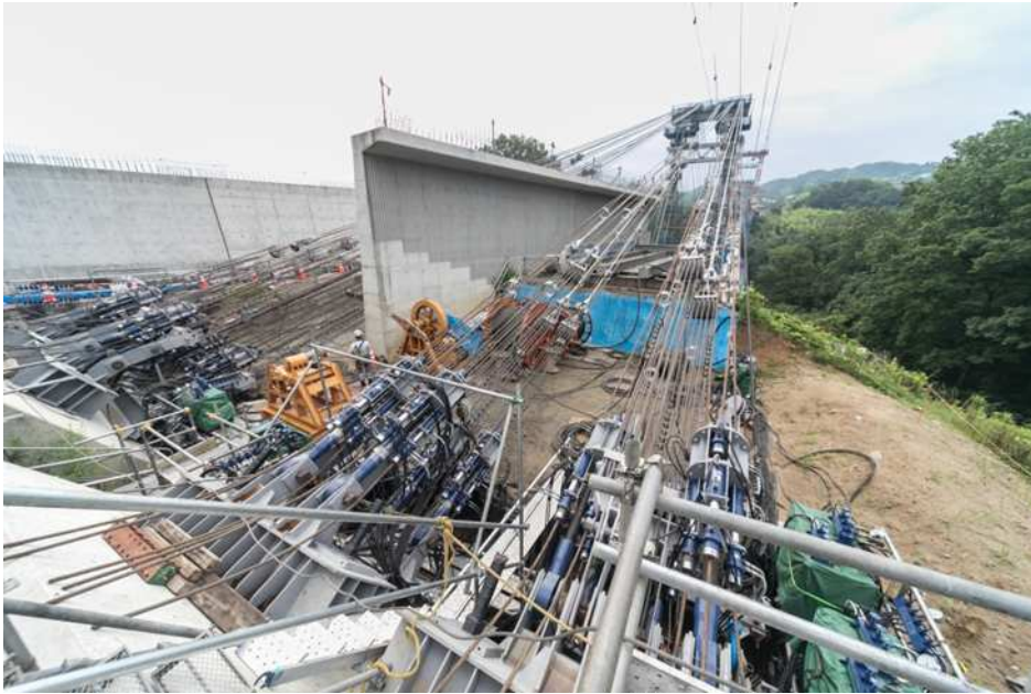
○ケーブル調整装置
