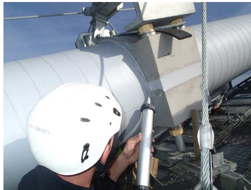
〈ケーブルバンド部コーキング状況〉
