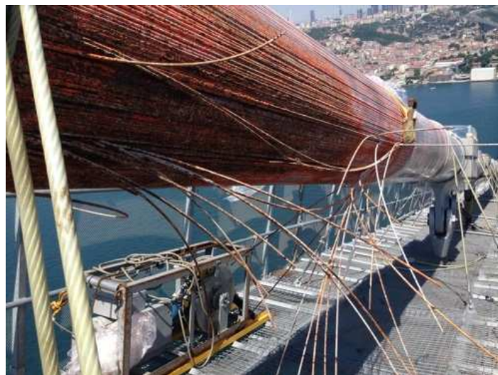
〈補修前の素線破断状況〉
