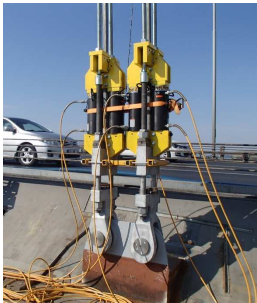
〈ジャッキング設備〉
