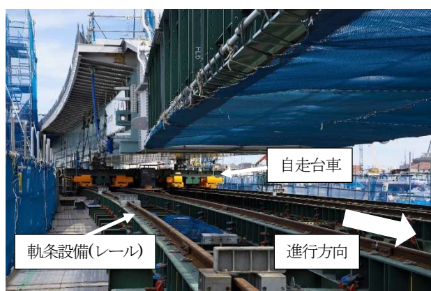
写真－1 曲線軌条上自走台車設備
