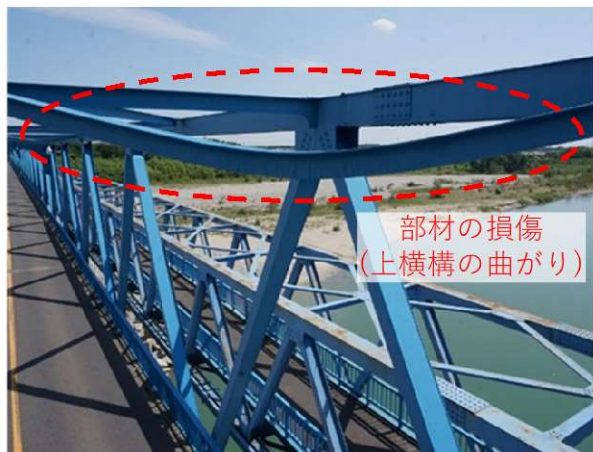
写真-2 部材の損傷状況
