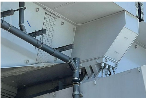
写真 4-8 負反力対策支承 (B-07 橋)
