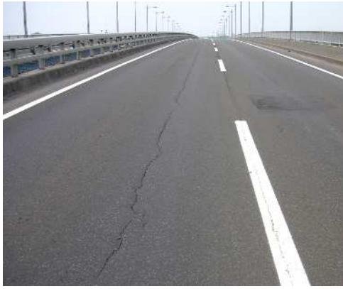
写真-1 主桁ウェブ上の舗装ひび割れ
