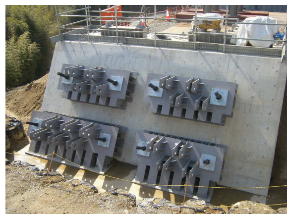
写真-2 斜吊り索定着設備
