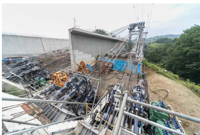
写真-5 ケーブル調整装置
