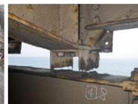
▲シェッド主梁端部破断
