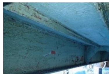
桁の塗装劣化やさびの発生
