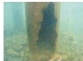
▲橋脚水中部の断面欠損
