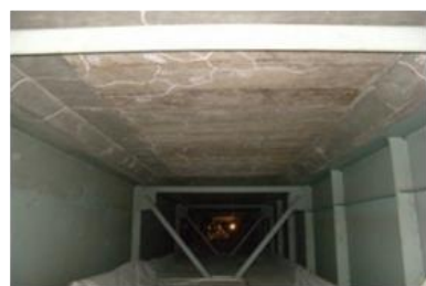
ひび割れの発生
