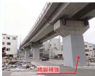
国道45号(観測震度: 震度6弱)
