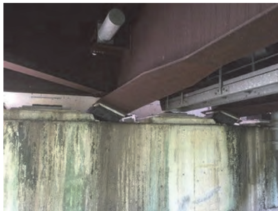
写真-5.2 A2 橋台部の損傷状況
