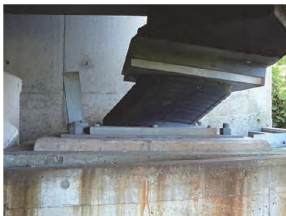
写真-6.39 A1 ゴム支承の残留変形
