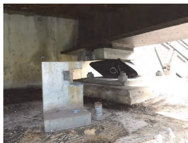
写真-6.44 橋台（側道橋）左岸側 支承の損傷
