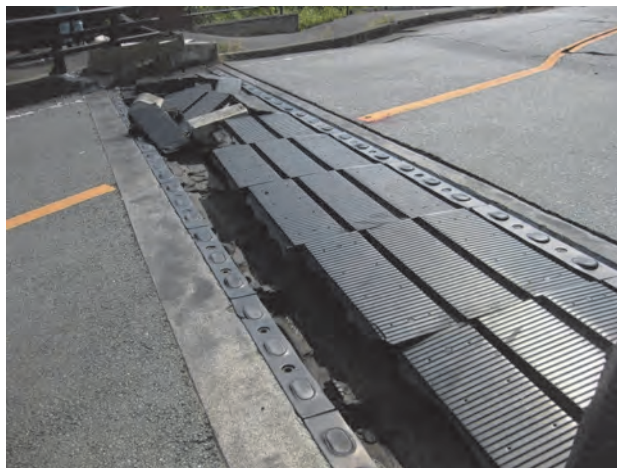
写真-6.3 A2 伸縮装置破損
