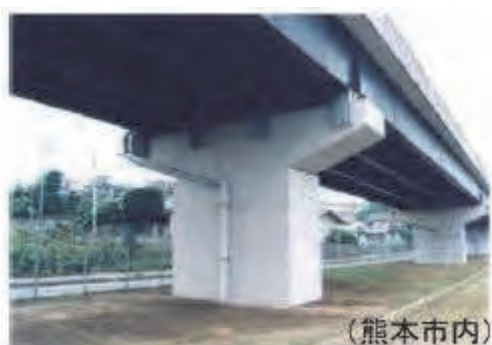
写真-8.1 耐震補強実施(損傷は限定的) 1)
