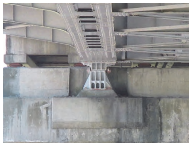
写真-6.56 左岸側 支承の損傷
