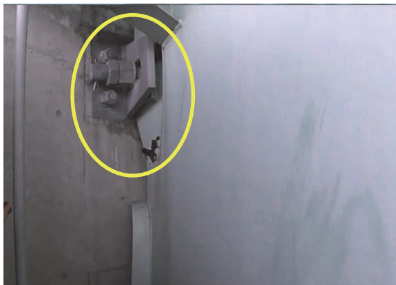
写真-8.8 主桁の損傷（大正橋）
