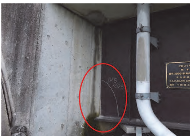
写真-6.43 橋台（側道橋）左岸側 腹板の損傷
