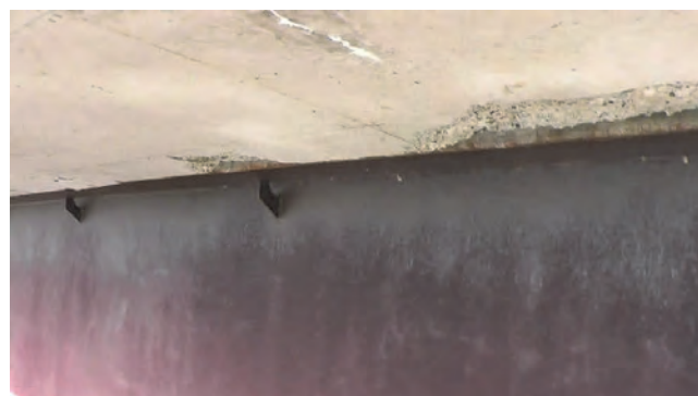
写真-6.49 床版張り出し部の剥落
