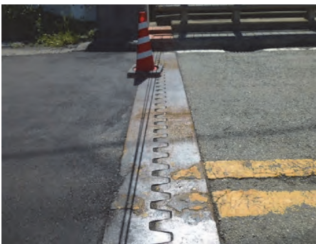
写真-6.29 A1 側伸縮装置 遊間無し
