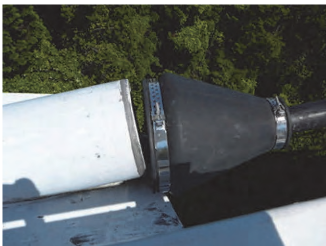
写真-6.9 斜ケーブルソケットカバーの脱落
