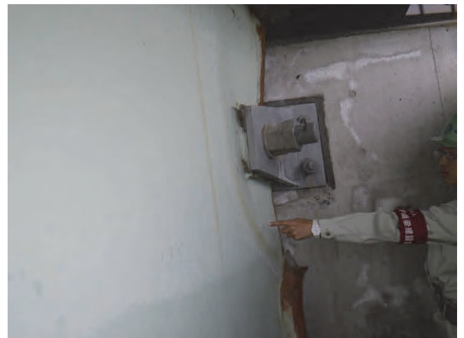
写真-6.33 A2 G1 桁端部腹板の変形
