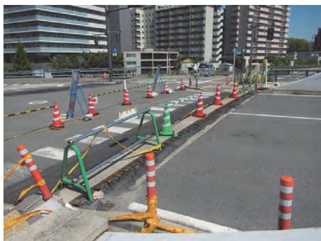
写真-6.57 右岸側 伸縮装置の破損
