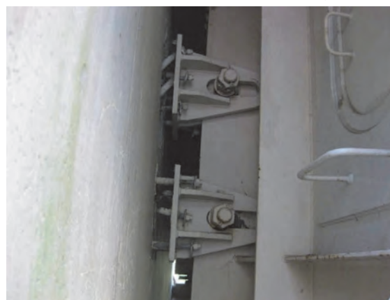
写真-5.4 A1橋台部の損傷状況
