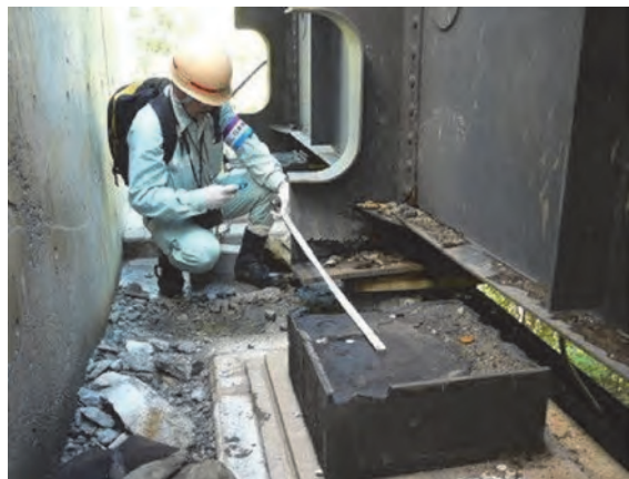
写真-5.1 A1 橋台部の損傷状況
