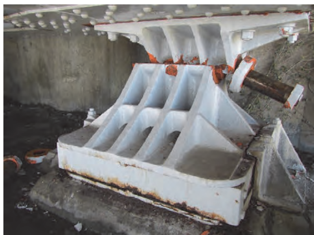
写真-6.55 右岸側 支承の損傷
