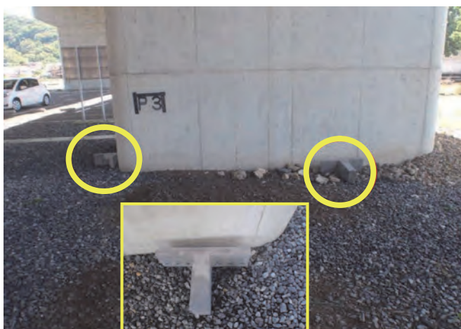
写真-7.16 サイドブロックの落下（田浦高架橋）
