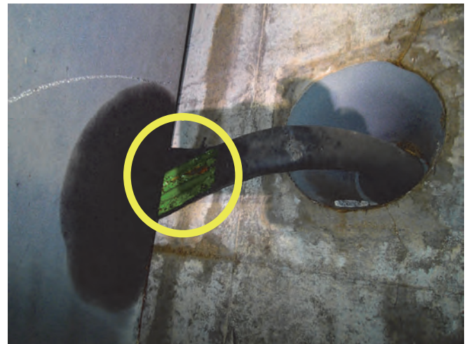
写真-6.13 落橋防止ケーブルの損傷
