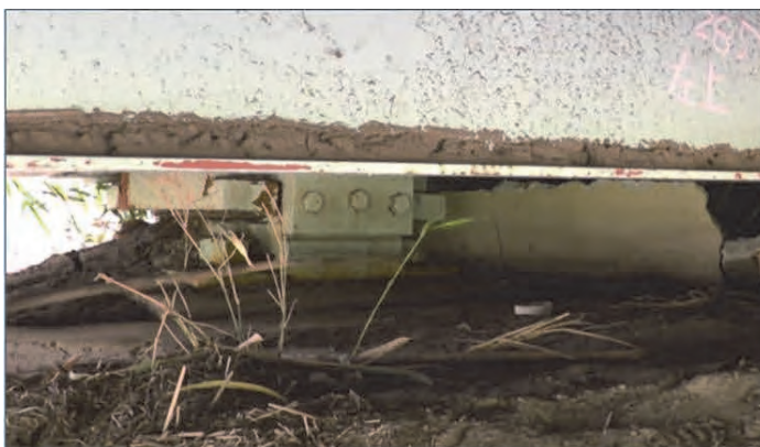
写真-6.34 A2 G2 桁支承の損傷
