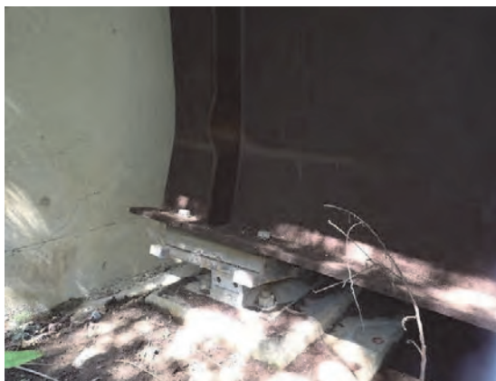
写真-5.13 平成長野大橋 主桁の損傷
