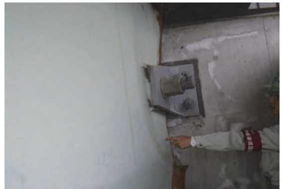
写真-5.12 大正橋 主桁腹板の損傷 (A2 橋台部)
