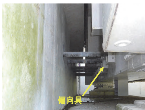
写真-7.19 端横桁の偏向具（新阿蘇口大橋）
