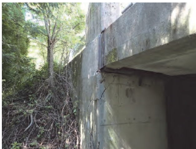
写真-6. 24 A2 橋台パラペットのひび割れ
