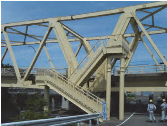
写真-6.17 P3 橋脚（取付歩道部） 取付歩道部階段の脱落
