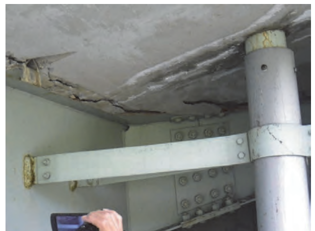
写真-6.35 A1 G2 桁部 床版下面の損傷
