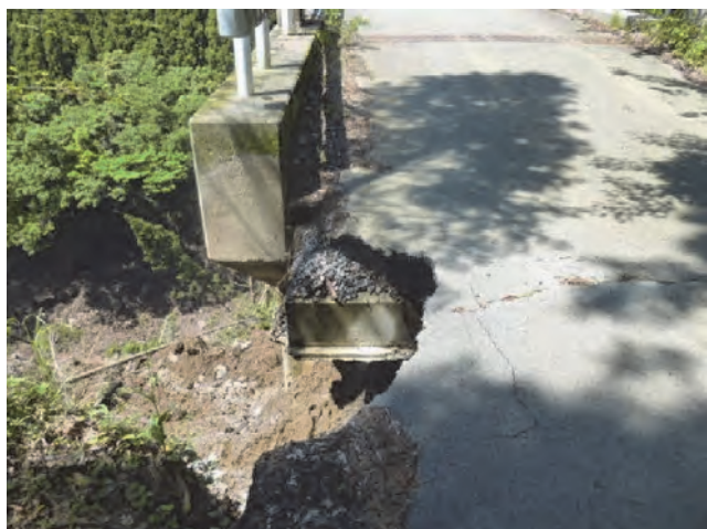
写真-6. 23 A1 橋台背面の土砂崩落
