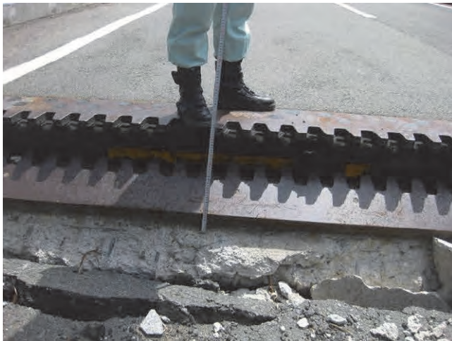
写真-6.7 A2 伸縮装置（約 40cm の段差）
