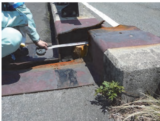
写真-6.37 A1 伸縮装置の破損（約 30cm 移動）
