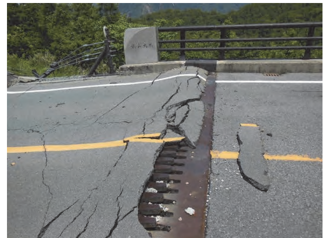
写真-6.15 A1 橋台 伸縮装置に舗装乗上げ
