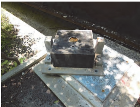
写真-5.5 A2 橋脚部の損傷状況
