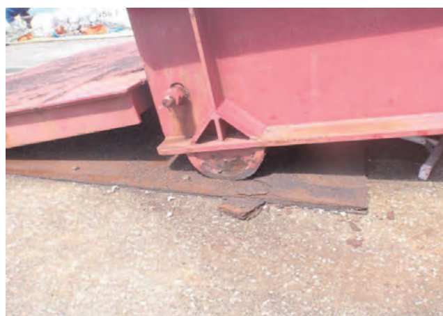
写真-6.53 海上側支点部 ベースプレートの腐食
