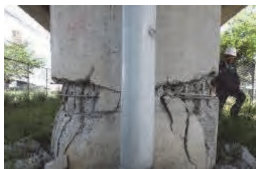
写真-8.2 耐震補強未実施(段落し部の損傷) 1)
