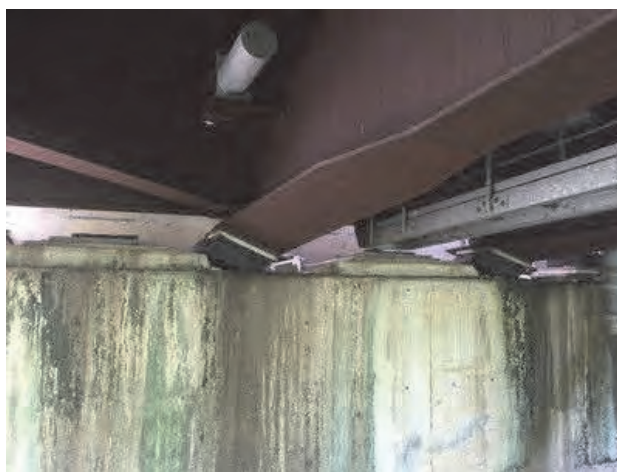
写真-6.5 A2 橋台支承積層ゴム下部で破断
