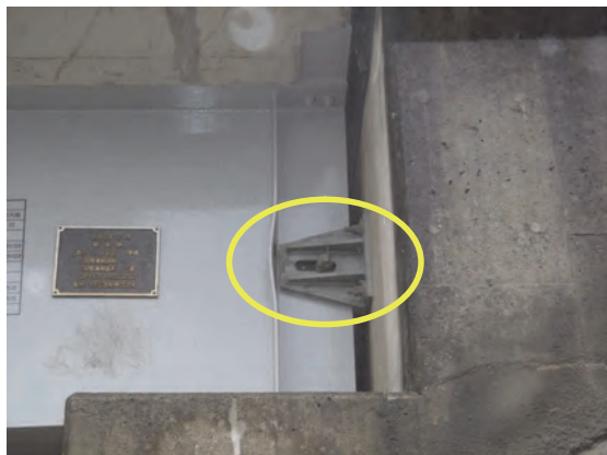
写真-7.7 旧基準の落橋防止構造による損傷
