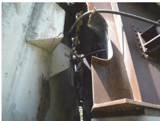
写真-6.4 A2 桁端部腹板等変形
