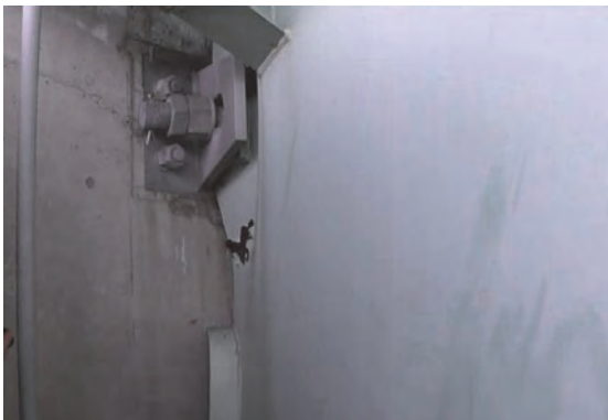
写真-5.11 大正橋 主桁腹板の損傷 (A1 橋台部)
