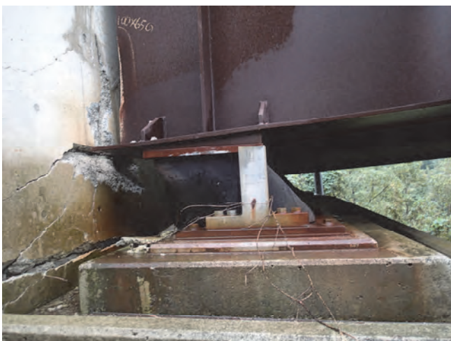
写真-6.14 A1 橋台 積層ゴムの残留変形
