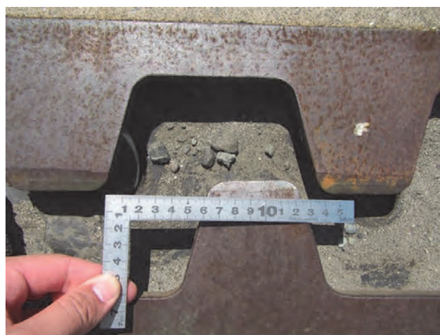
写真-6.58 左岸側 伸縮装置の移動（約 30mm）
