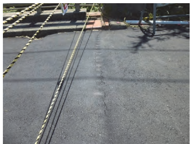
写真-6.30 A2 側伸縮装置 遊間大 (応急復旧済)
