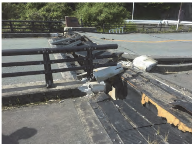
写真-6.2 A1 伸縮装置破損
