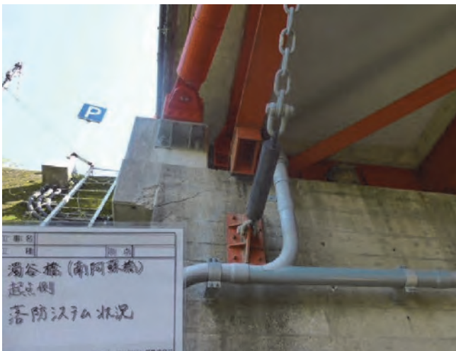
写真-6.27 A1 側制振ダンパー コンクリート基部のひび割れ
