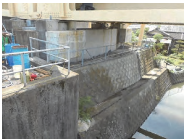
写真-6.19 P3 橋脚（起点側）約 2.25m 沈下
