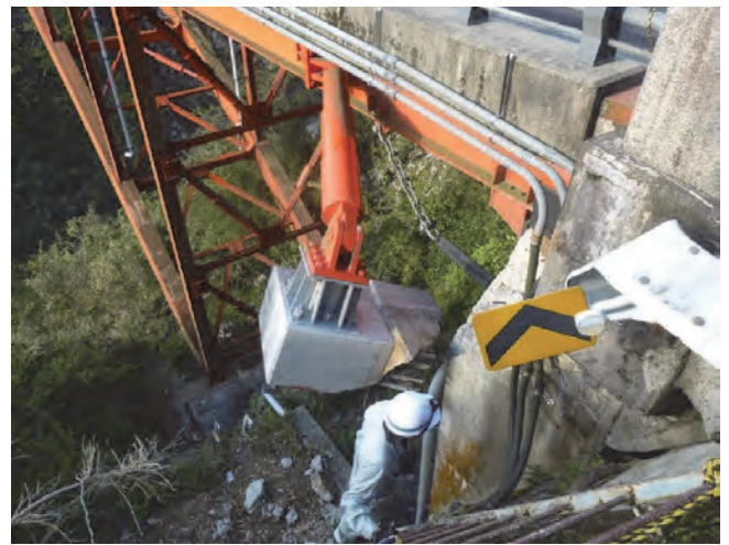
写真-6.28 A2 側制振ダンパー コンクリート基部破損
