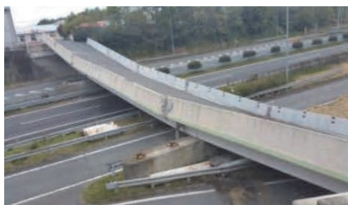
写真-8.10 府領第一橋の落橋 1)
