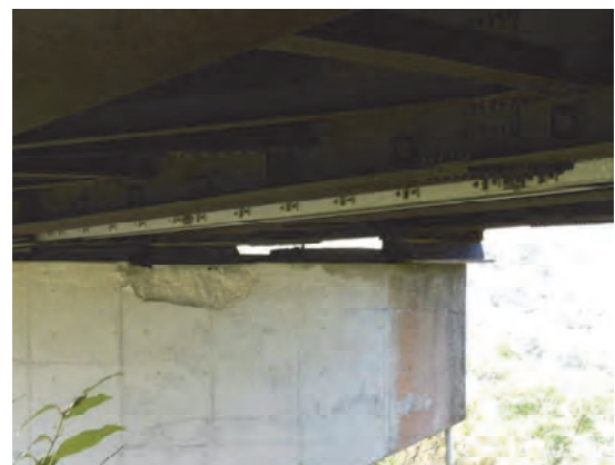
写真-5.6 P2 橋台部の損傷状況
