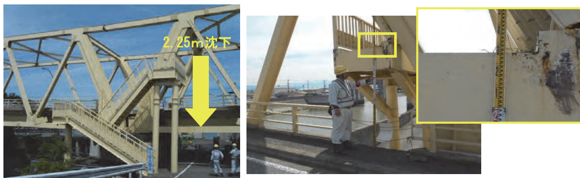
写真-7.9 P3 橋脚が 2.25m 沈下した状況（横江大橋）
