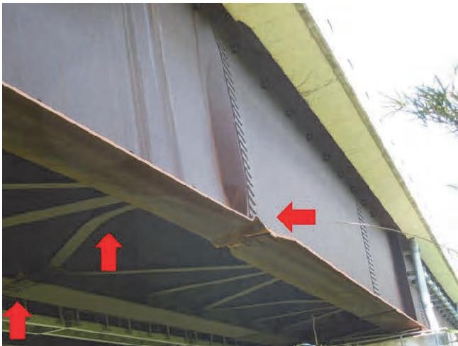
写真-6.12 腹板、下フランジ等座屈
