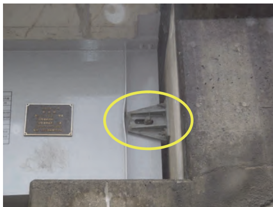
写真-8.9 主桁の損傷（阿蘇口大橋）
