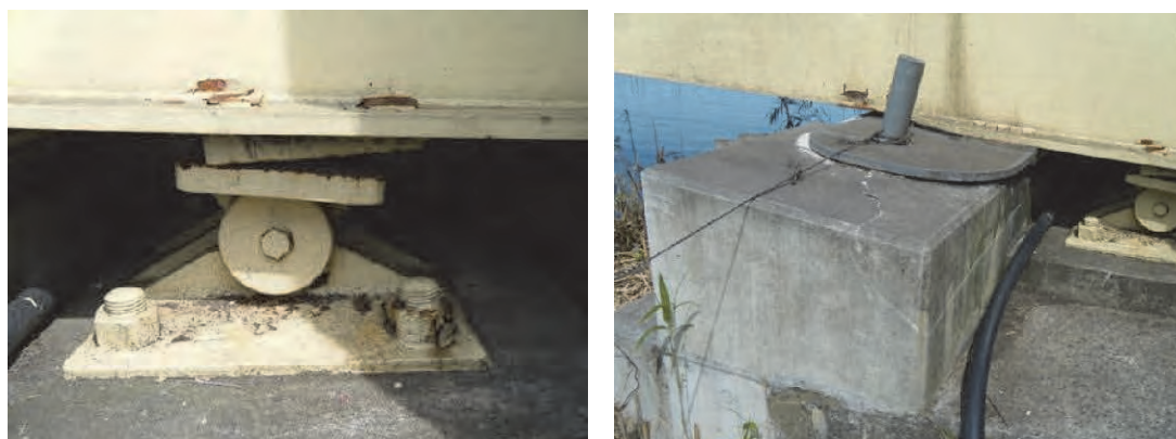
写真-7.10 支承セットボルトの脱落と変位制限構造の損傷（横江大橋）
