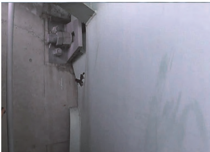
写真-6.32 A1 G1 桁端部腹板の変形
