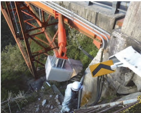
写真-5.9 南阿蘇橋 ダンパー基部の損傷
