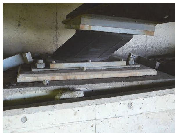
写真-6.40 A2 ゴム支承の残留変形
