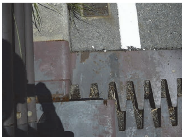
写真-6.38 A2 伸縮装置は A1 と反対方向に移動して破損
