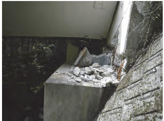
写真-6.8 A2 支承セットボルト破断
