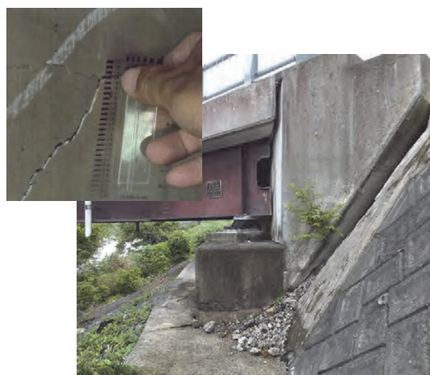
写真-6.47 橋台パラペットの空隙と 亀裂（約 1.4mm）
