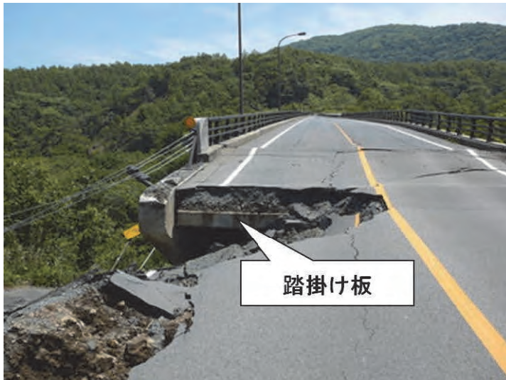
写真-6.11 A1 橋台背面 土砂崩落
