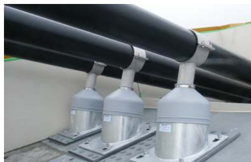
写真-17 斜ケーブルの制振対策
