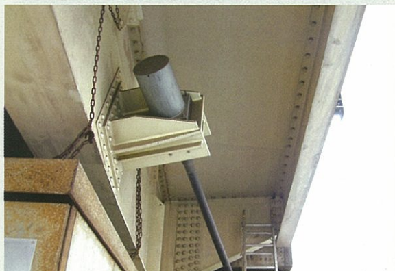
床版張出部下面の状況
