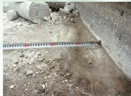
《写真》路肩部の凍害による土砂化(舗装劣化部)
