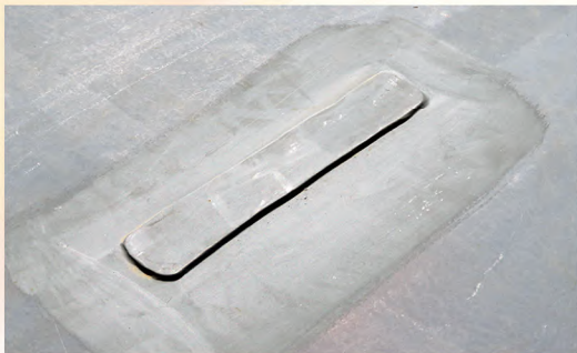
図-4 吊金具残し部の高さ2mm程度の事例
