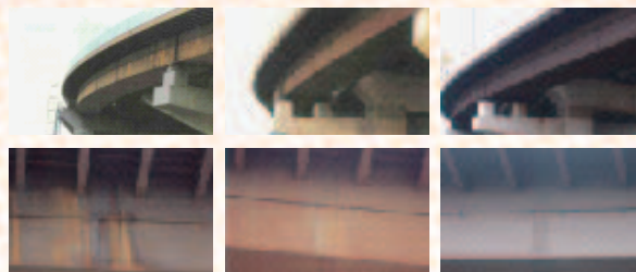
竣工 約2ヶ月 約1年 約28年
