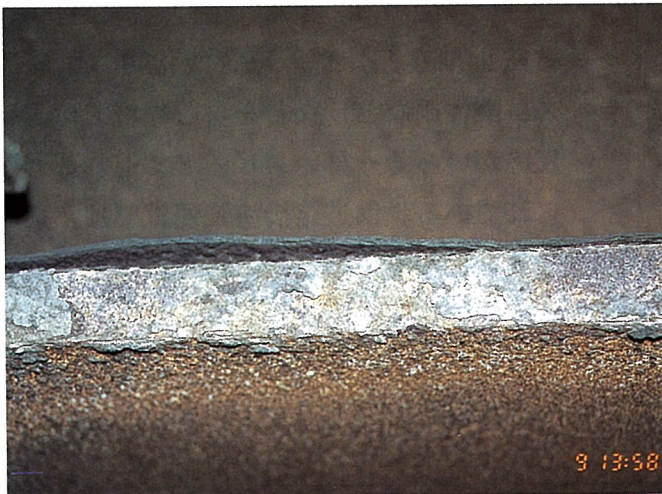
写真－４・３・３ デトロイトの掘り割り式交差橋梁 (1970年頃架設 未補修の橋梁 下フランジの上面に層状はくりさびが見られる)
