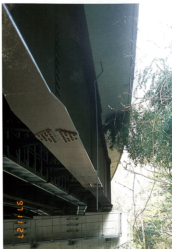
写真-8 スラブドレーン管からの排水 (当初は床版下面から20cm程度しかなかった)
