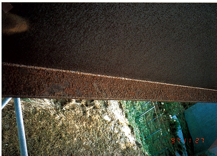
写真－11 上下線橋梁の高低差（下フランジ状況）
