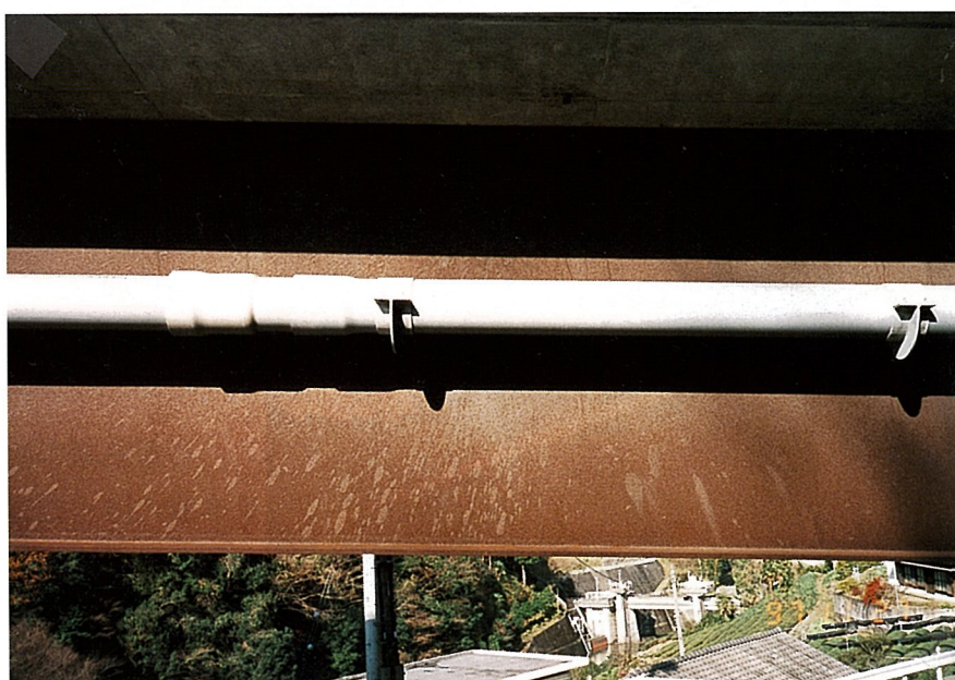
写真-9 排水管からの漏水 (管伸縮継目の止水構造不備)
