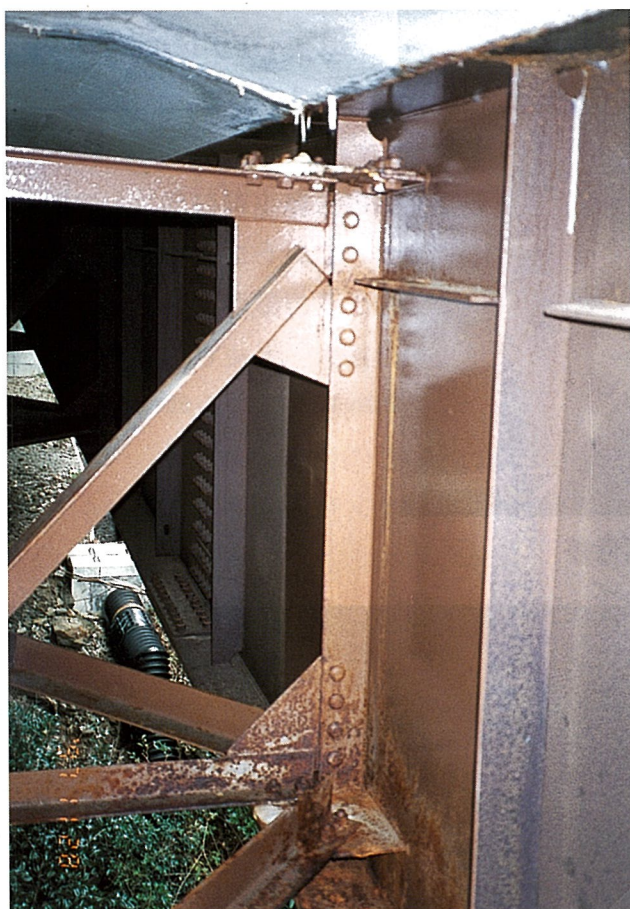
写真-7 床版のクラックからの漏水
