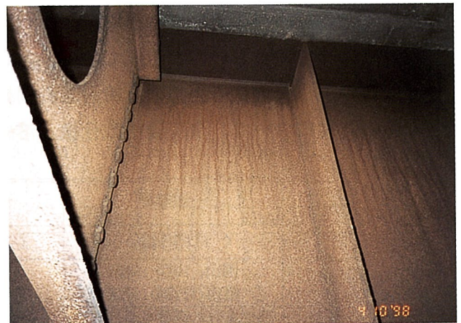
写真－４・３・４ デトロイトの掘り 割り式交差橋梁 (1970年頃架設 未補 修の橋梁 上フランジとウェブはそれほど 悪いさび状態ではない)
