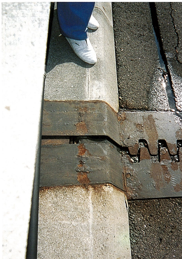
写真－３ 伸縮継手からの漏水 (地覆の途中から浸水する)
