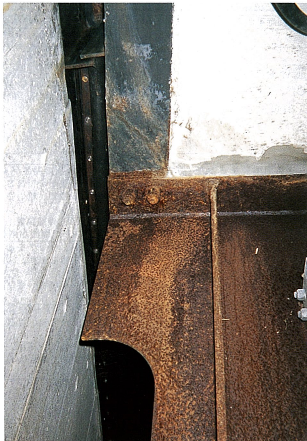
写真－４ 伸縮継手からの漏水
