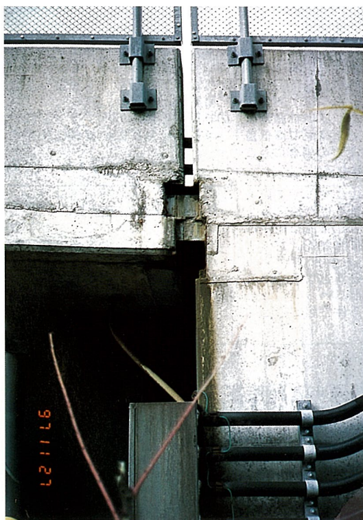
写真－５ 壁高欄隙間からの越流水
