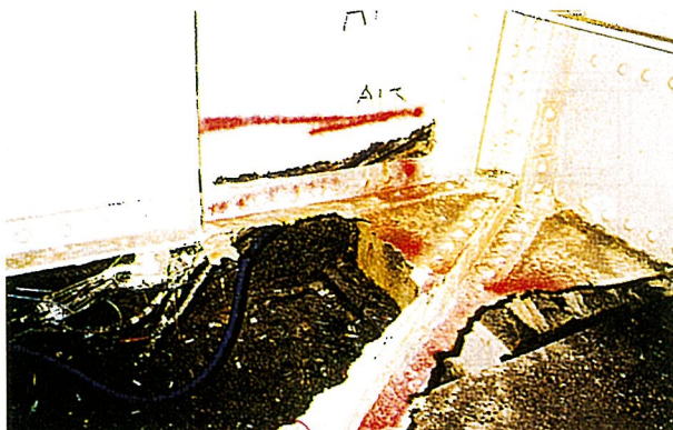
写真-11 端横桁の腐蝕状況
