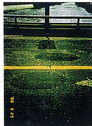
写真-6 下路アーチ橋の舗装路面のひび割れ状況
