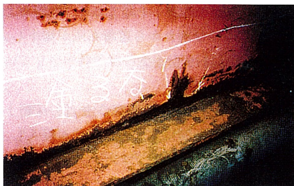
写真－17 主桁溶接部の腐食状況
