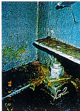
写真-2 桁端部における腐食事例（その1）
