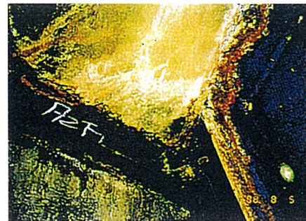
写真-3 桁端部における腐食事例（その2）
