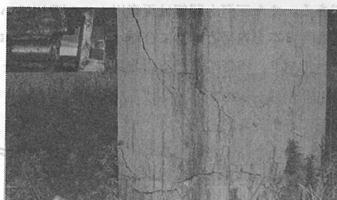
関上大橋の被災状況
