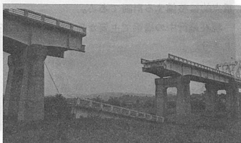
ゲルバー吊桁一連が落橋した錦桜橋
