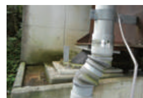
排水管の変形
