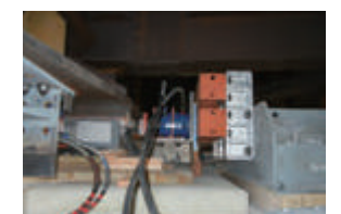
中間支分部支承変位解放設備
