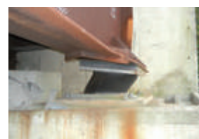
A1橋台ゴム支承上の下フランジの変形
