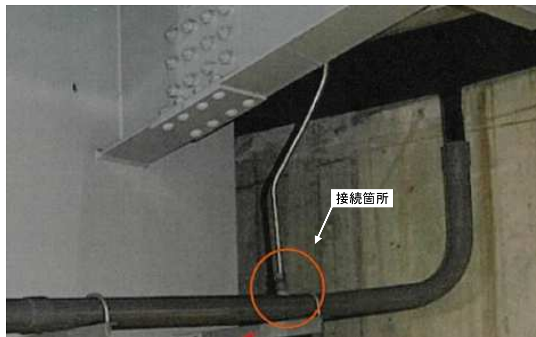
排水管とフレキシブルチューブの接続箇所 実例
