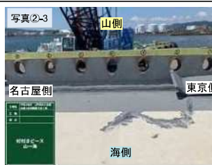
コネクションプレートのボルト穴は塑性変形
