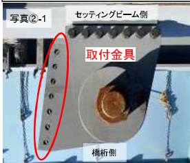
橋桁側の取付金具のボルトは全て無くなっている
