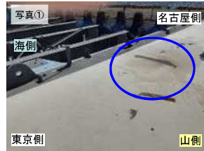
写真①橋桁上フランジに凹み
