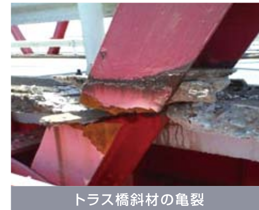
コンクリート埋込み部の腐食による亀裂
