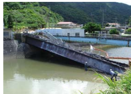
2009年に落橋した 辺野喜橋(沖縄)
