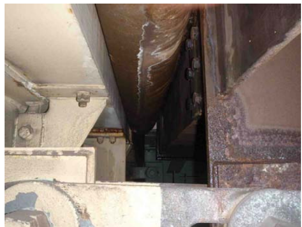
写真-4 伸縮装置からの漏水と桁端の腐食状況
