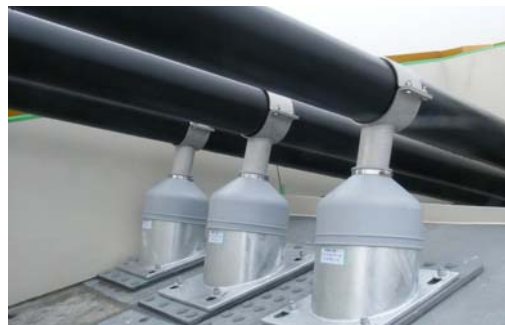
写真-17 斜ケーブルの制振対策
