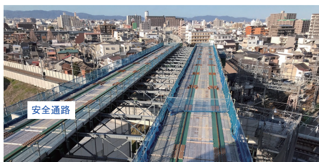
写真-3 軌条桁上面の安全通路
