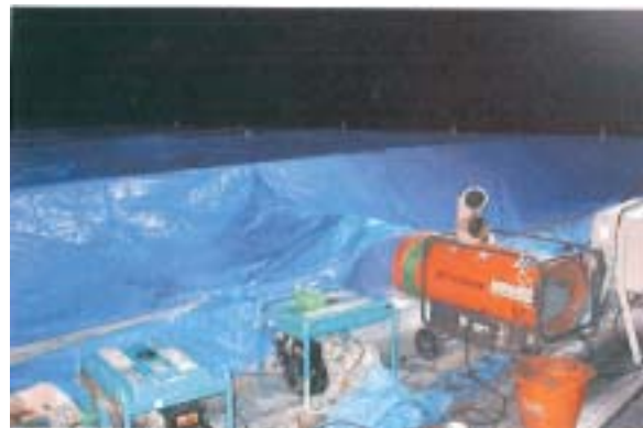
写真-2 コンクリート打設後のジェットファンヒーターによる給熱保温養生
