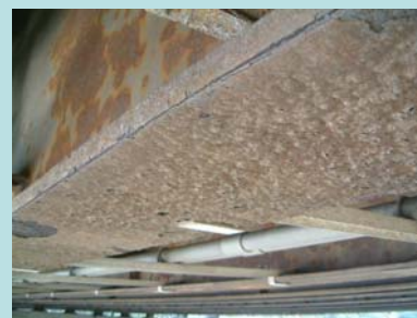
飛来塩分による損傷
