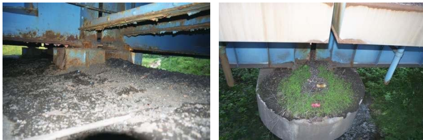
伸縮装置からの土砂が堆積、支承も埋まっている
