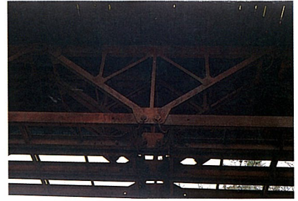
三角形のトラス部材がピン結合されているのが良く分かる。 1996.1
