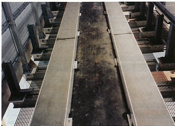
写-12 レインボブリッジ吊り橋部 軌道間以外はグレーチング構造。(案内軌条・電車線設置前)
