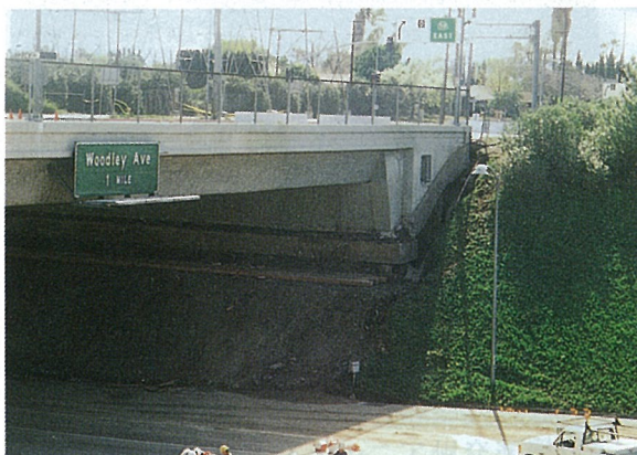
フリーウェイ118号線とバルボアストリートの交差部橋梁（上流にある水道管の破損により洪水になり下部が洗掘された）
