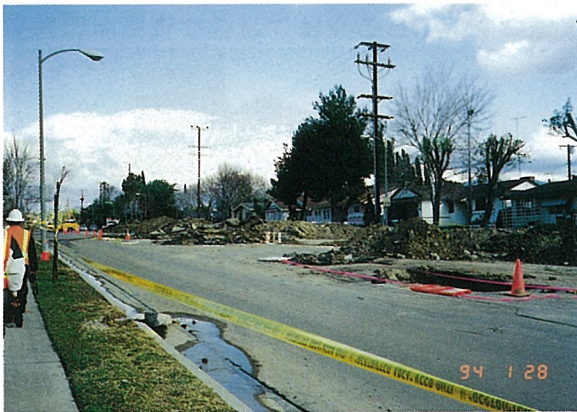
グラナダヒル・バルボアストリートのライフラインの被害（黄のテープ内が作業区域となっている。カルトランの作業ユニフォームによる調査）
