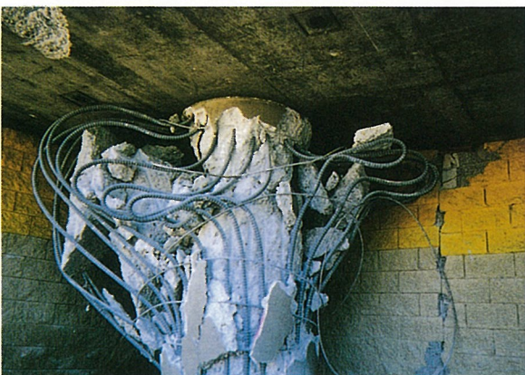
鉄筋コンクリート円柱脚のちょうちん座屈 (1961.4施工、帯鉄筋が少ない。1971年に 設計基準が改正され帯鉄筋は3倍、10cm ピッチになった)
