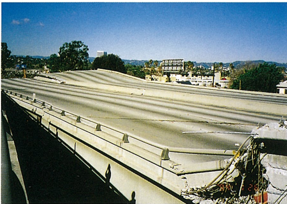
サンタモニカフリーウェイ（10号線）高架橋 の崩壊（6径間連続鉄筋コンクリート箱桁、 鉄筋コンクリート円柱、上部構造と剛結）
