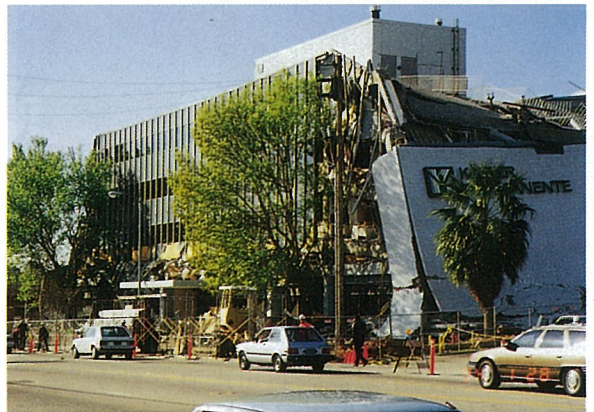
グラナダ・ヒル地区のKaiser Permanente ビルの崩壊
